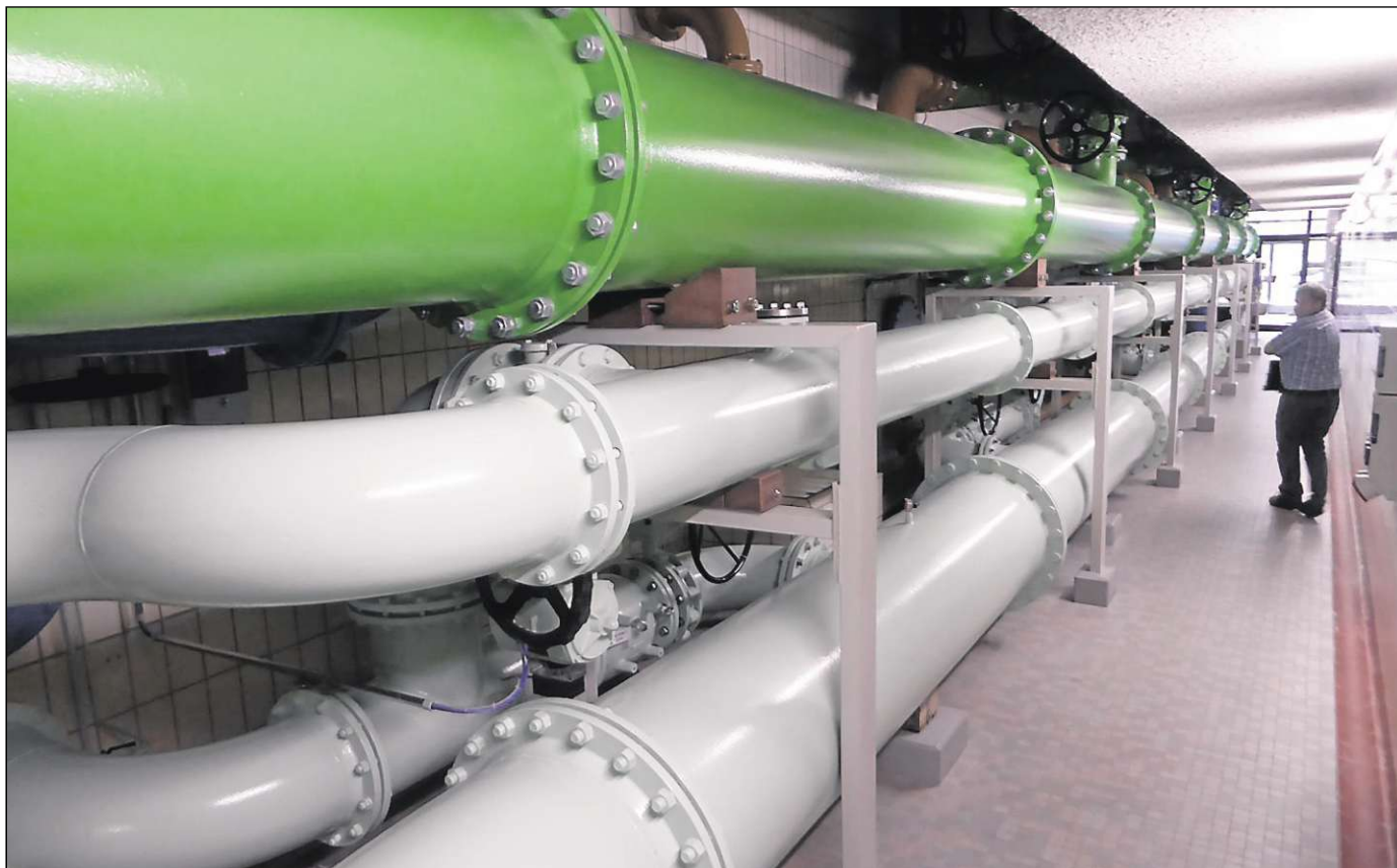
Ein gewaltiges Rohrsystem durchzieht das Wasserwerk in Wildeshausen. Die Farbe der Rohre zeigt den Status des Wassers, das sie weiterleiten. Je heller diese ist, desto fortgeschrittener ist der Aufbereitungsprozess. • Fotos: Hannig
